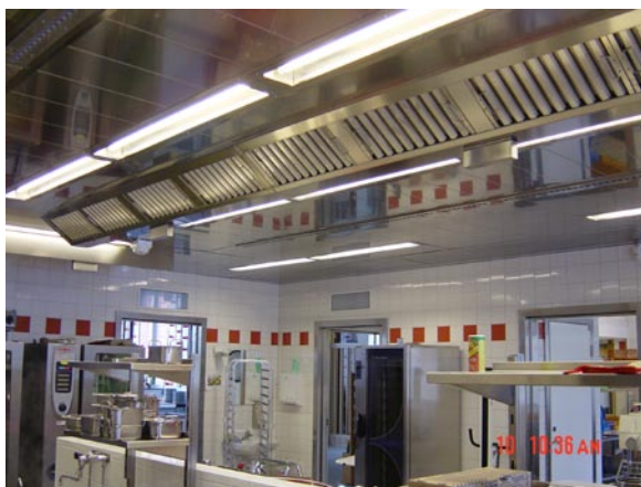
Ventilationstak i ett skolmåltidskök i Falun
