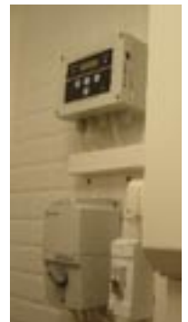
Kontrollpanel TCP monterad på vägg
